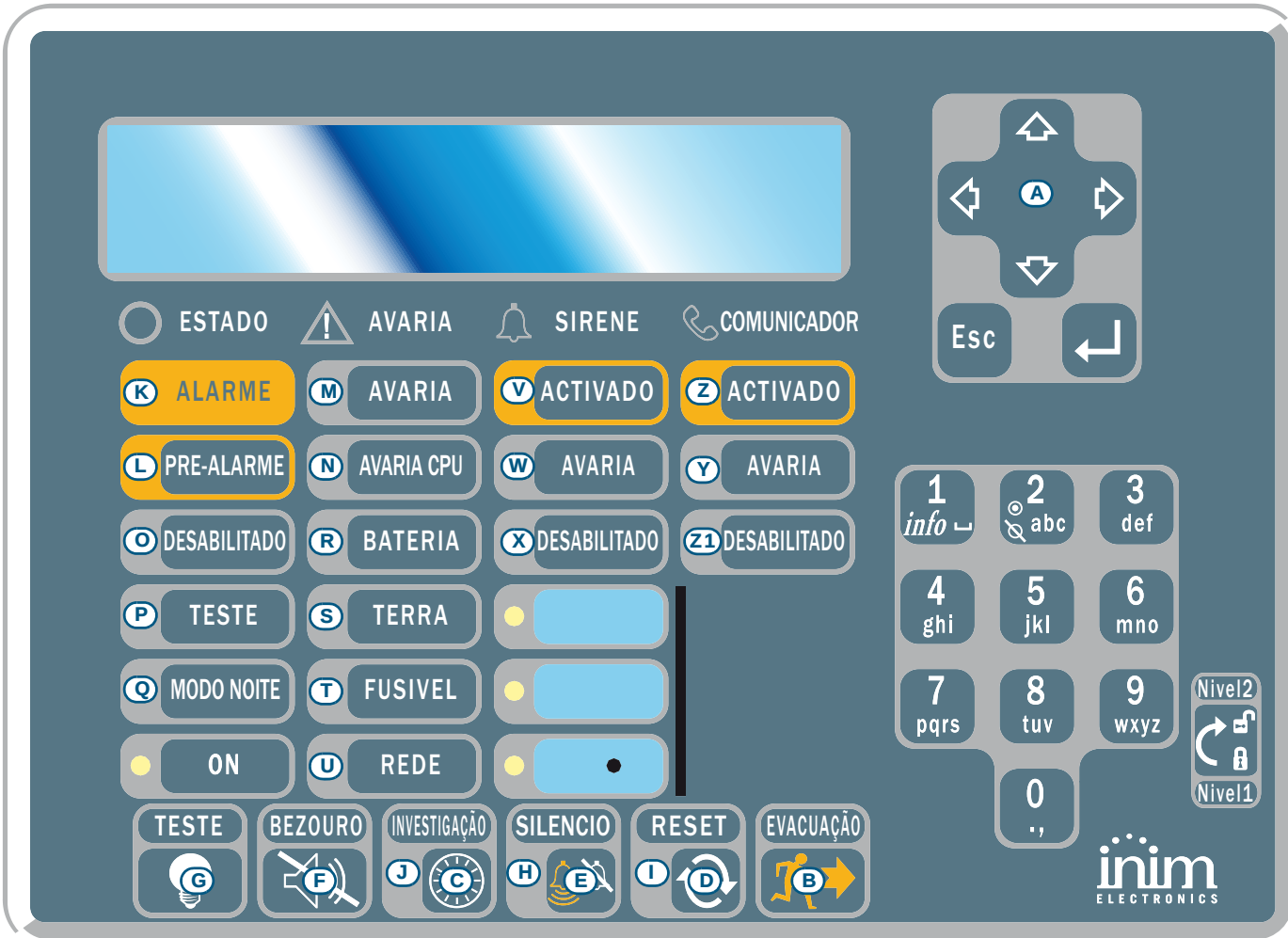
Figura 2 - Vista frontal do repetidor
